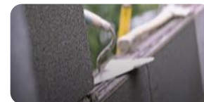
MORTARE PENTRU ZIDIRE
